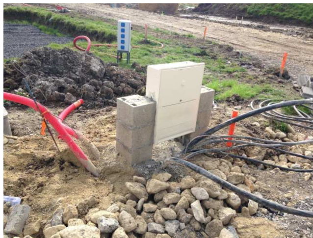
Poste de Transformation
